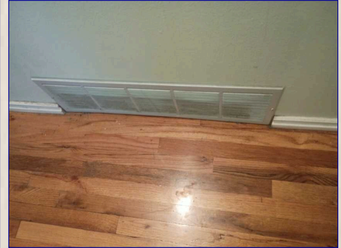
Hallway Return Air Grille
